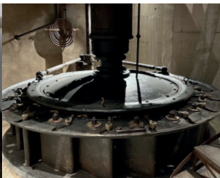
Aus der Geschichte der Papieri_Francisturbine wurde 1909 eingebaut.
